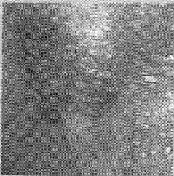
Alvéole I. le mur M1 englobe un mur plus ancien - Pièces de fondations mal jointées - Triangle de béton visible.
