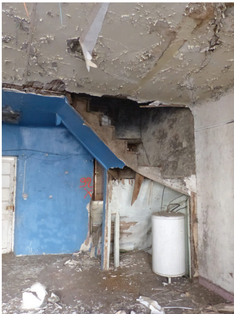
Fig. 2. Vue de l'intérieur d'une des pièces en rez-de-chaussée des bâtiments à démolir et de l'instabilité des étages (façade est, côté petite rue Marchaux). Cliché Katia Lagorsse, Inrap.
