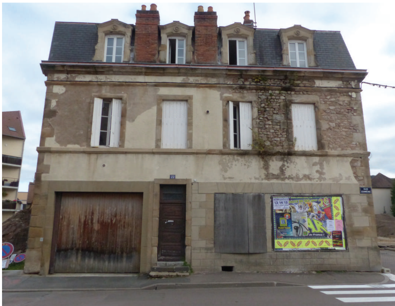
Fig. 1. Vue générale des bâtiments à démolir, façade nord-ouest. Les problèmes d'humidité visibles en façade ont entraîné le développement de champignons lignivores aux étages.
