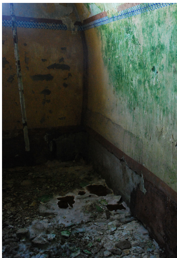
Fig. 79. Geôle PR_R2_17 : photographie prise en 2013 ; présence de mérule active au sol. Cliché C. Massard
