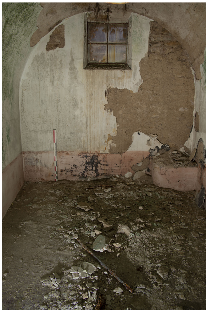
Fig. 9. Vue d'une cellule où la dégradation des enduits laisse apparaître le parement des maçonneries. Cliché C. Couderc
