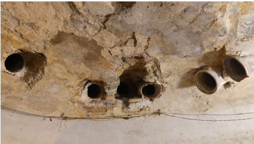
Fig. 44. Conduits prévus pour la diffusion de l'air chaud dans les niveaux supérieurs.
