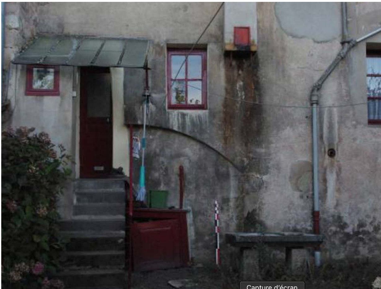
Fig. 31. Arc présent dans la partie basse du mur est (UM 2).
