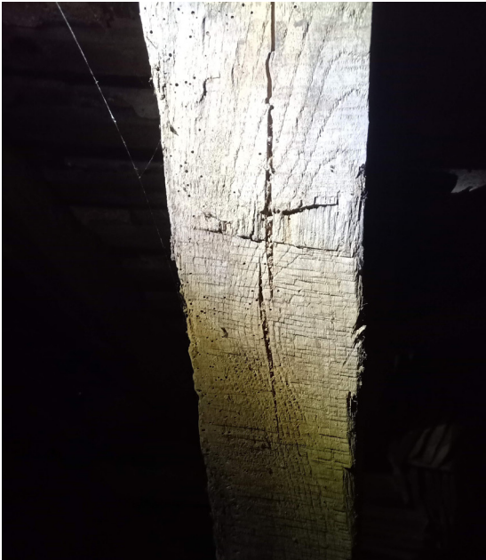
Fig. 33. Traces de sciage de long.
