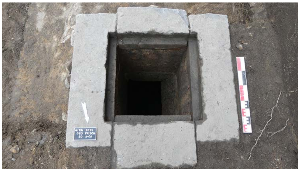
Fig. 42. Regard de visite dans le collecteur St.1 : aménagement 3.05 permettant de recevoir un bouchon.
