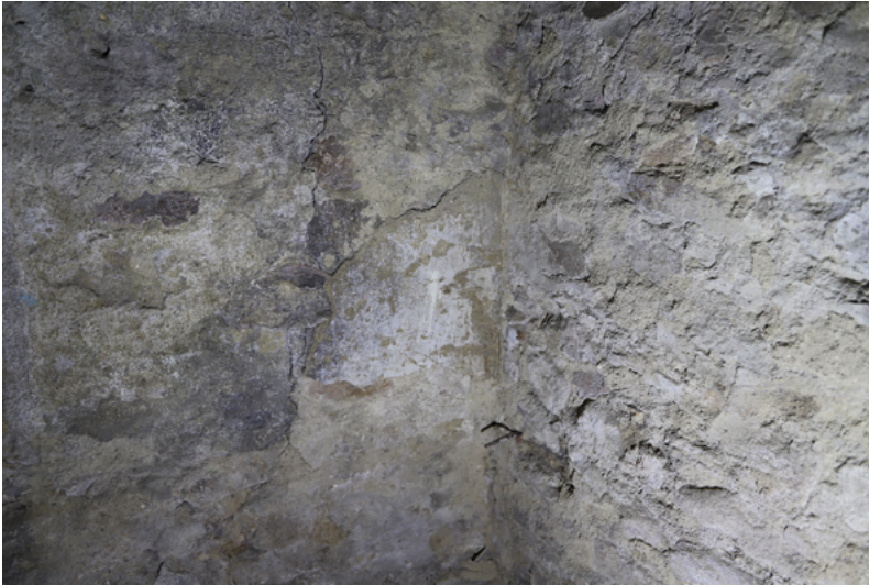
Fig. 26. Fragment d'enduit conservé dans l'angle entre les UM 3 et 4.
