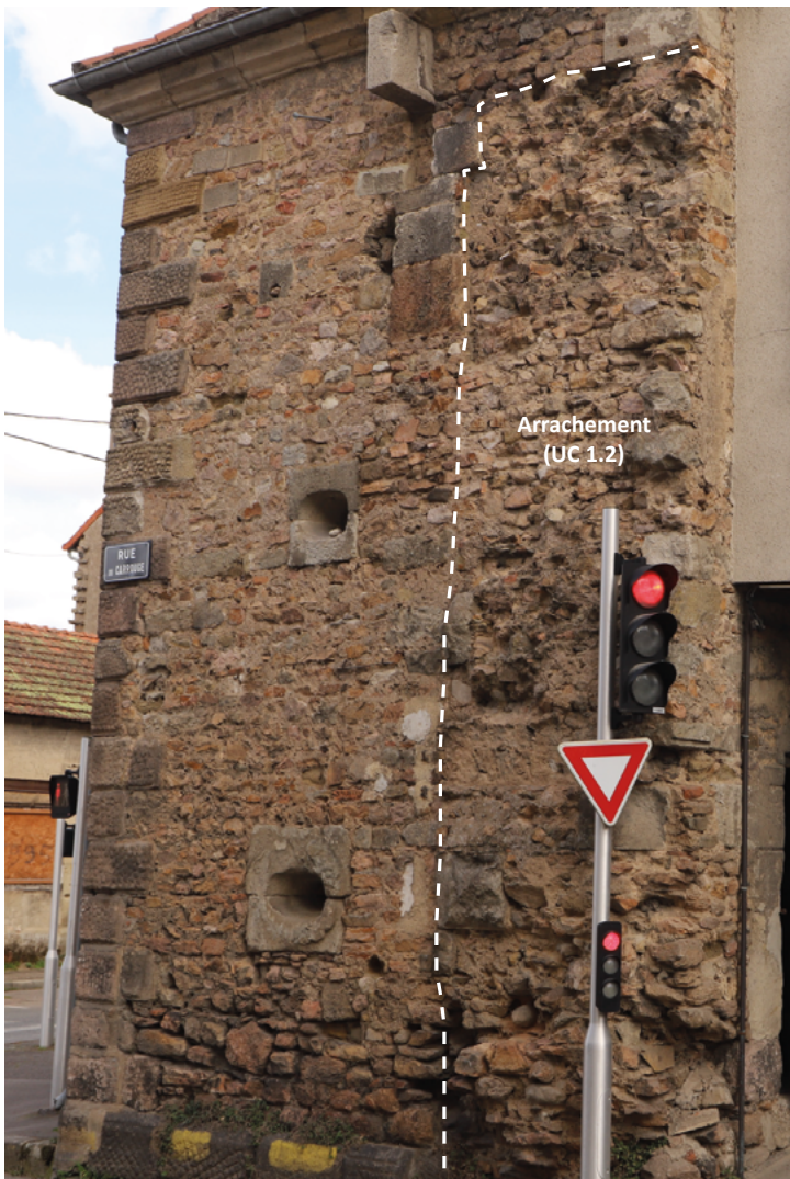
Fig. 14. Photographie annotée de l'arrachement de l'arche de la porte du Carrouge (UC 1.2). © DAO A. Belot
