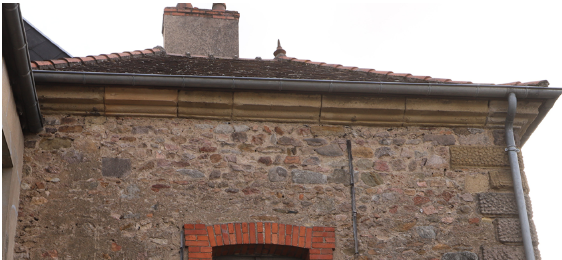
Fig. 64. Vue de la corniche au sommet de l'UM 2.
