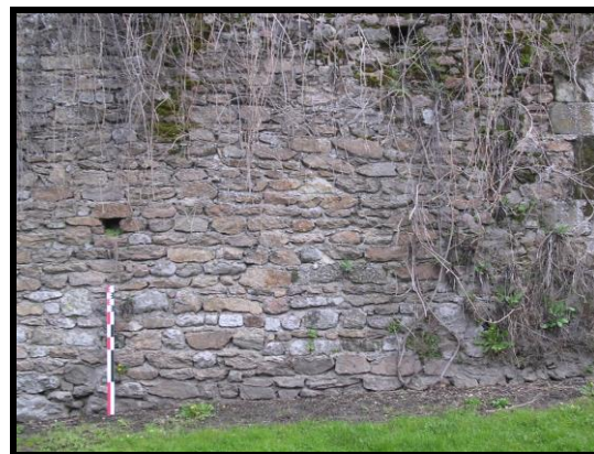
Photographie 118 : tronçon C30, trous de boulin (mire 1 m)
