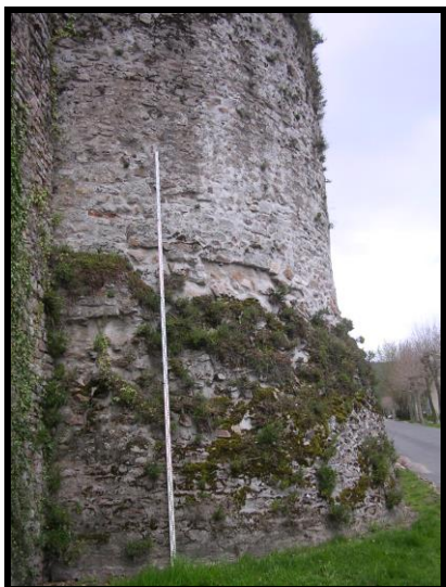
Photographie 99 : tour T18, face nord (mire 5 m)
