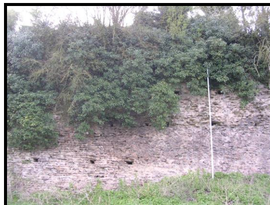
Photographie 145 : tronçon C38, trous de boulin (mire 5 m)
