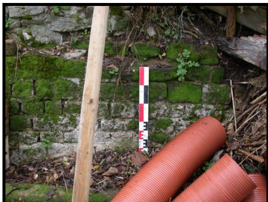
Photographie 13 : tronçon C5, détail des moellons du parement chez M. et Mme Hueber (mire 0,50 m)
