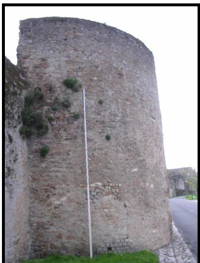
Photographie 105 : tour T19, face nord (mire 5 m)
