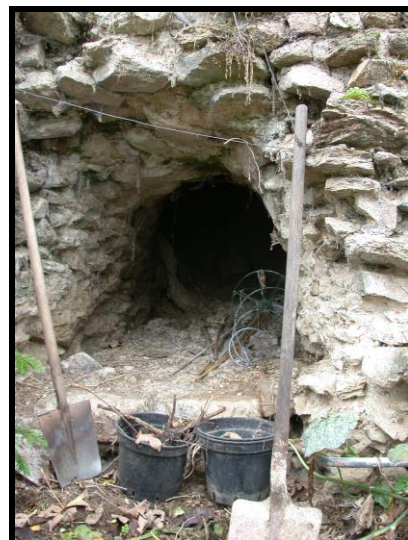
Photographie 14 : tronçon C5, percement de la courtine observé chez M. et Mme Hueber
