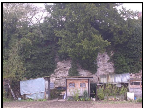
Photographie 137 : tronçon C36, trous de boulin
