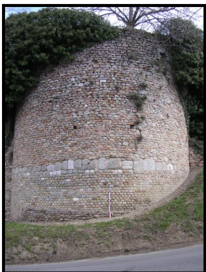
Photographie 71 : tour T13. La partie grisée, à gauche de la mire, à la base de la tour fait saillie vers l'extérieur (mire 1 m)
