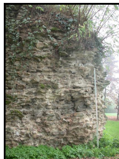
Photographie 18 : tronçon C6, face nord (mire 3 m)
