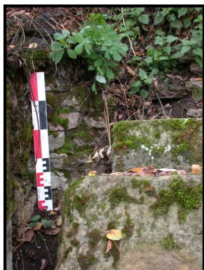
Photographie 10 : tour T2, détail des moellons du parement conservés, seuls indices de la présence d'une tour (mire 0,50 m)
