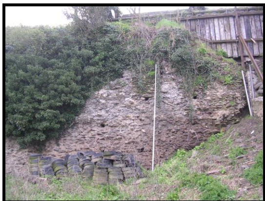
Photographie 142 : tronçon C37, trous de boulin (mire 5 m)
