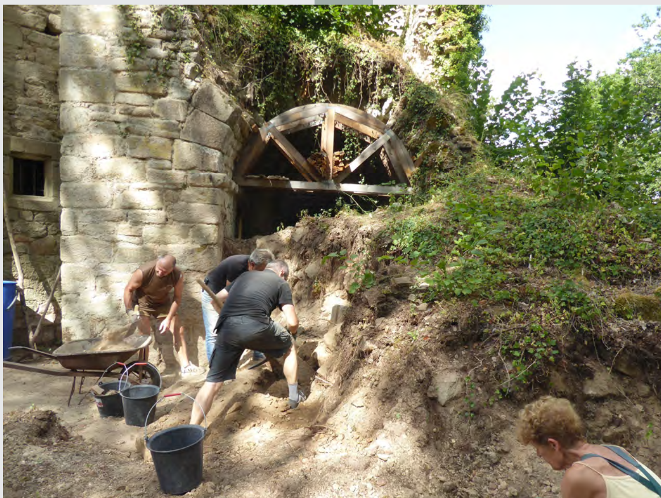
Fig. 6. Dégagement des déblais d'effondrement devant la tour-porte par les bénévoles de l'association. (Cliché C. Vallée, 2019)
